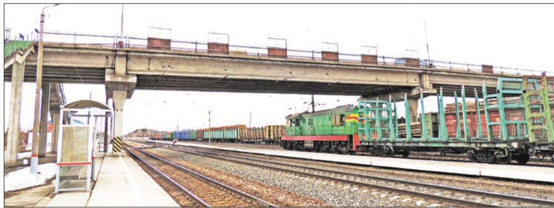
Путепровод у станции «Сухона» требует ремонта.
